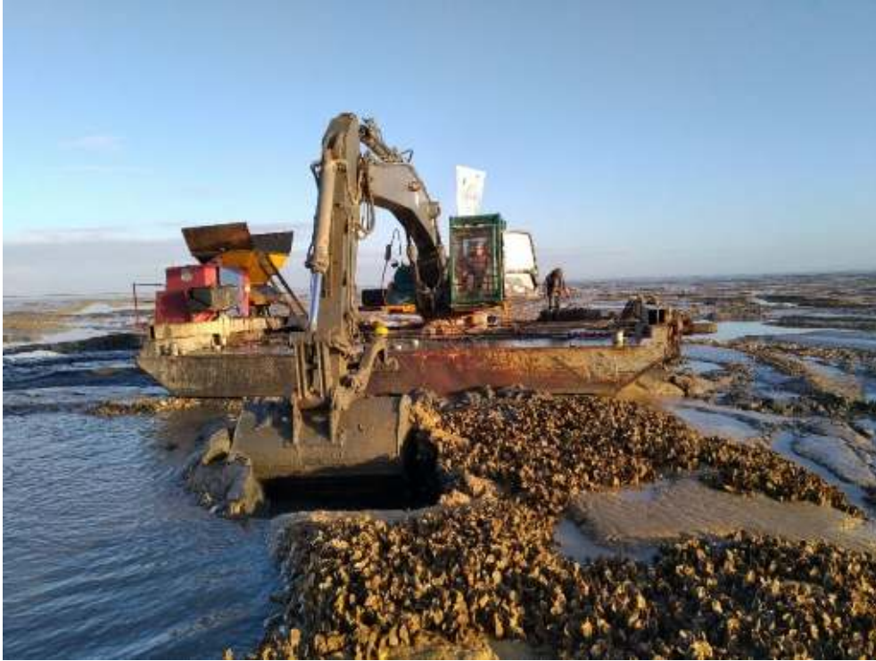
Photo n°2 : Machine 1 - Pelle hydraulique utilisée lors du chantier 2019/2020. Les coquilles d'huîtres sont ramassées à l'aide du godet puis passées dans le broyeur qui est sur la barge.
